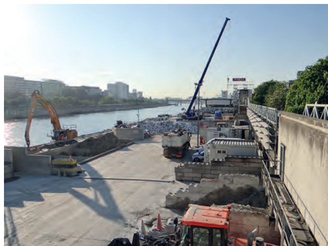
Déchets de chantier sur le site de Cemex au port d'Ivry-sur-Seine
