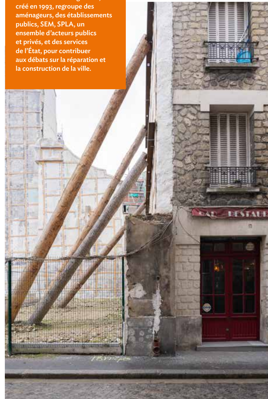
À Saint-Denis, la rénovation et la restructuration du bâti existant, un enjeu primordial. © Charlotte Dubois
