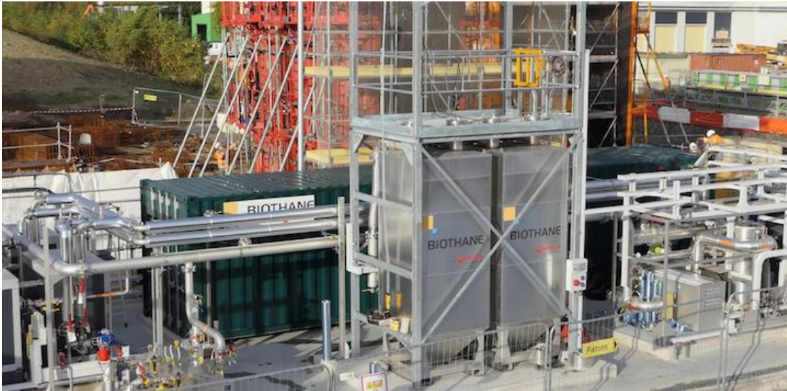
Les nouveaux équipements d'épuration du biogaz à la STEP de Bonneuil Source : SIAH Vallées du Croult et Petit Rosne
