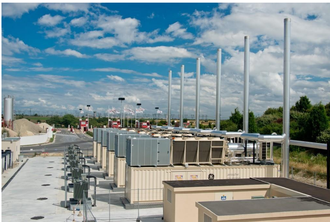
Centrale Electr'od de cogénération à partir de biogaz de l'ISDND du Plessis-Gassot (électricité et chaleur injectées sur réseaux) Source : Clarke Energy
