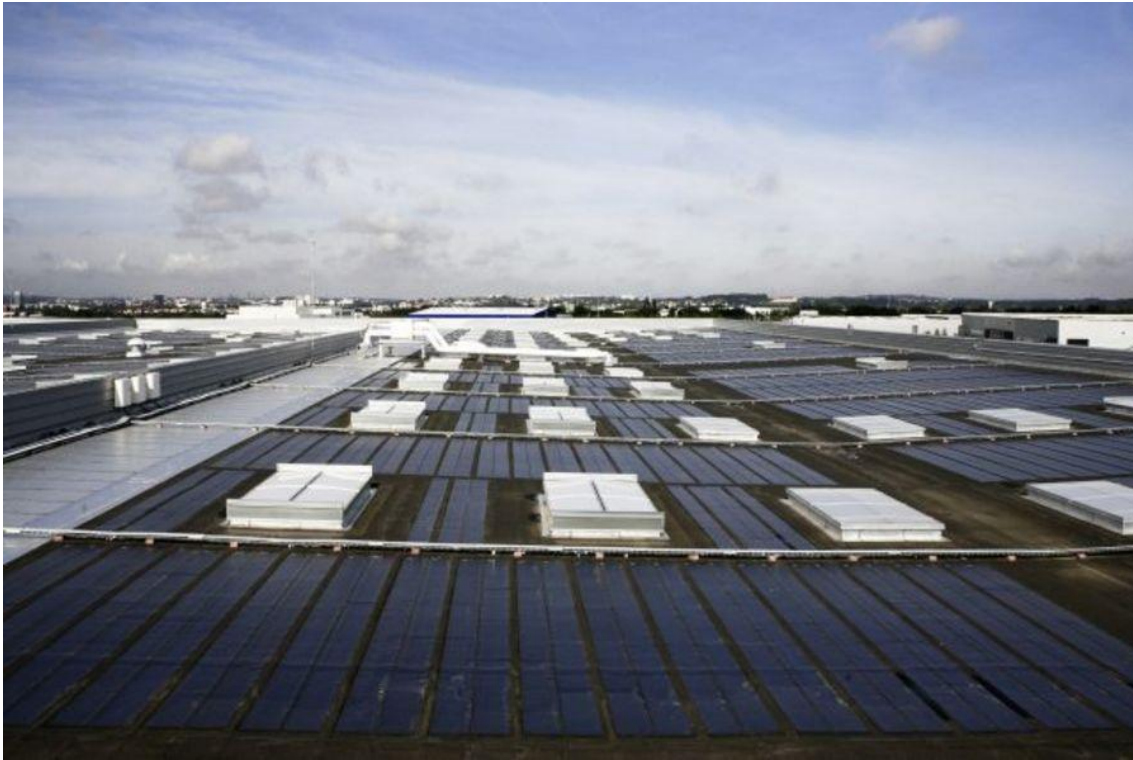
Toiture solaire photovoltaïque de l'entrepôt Sisley à Saint-Ouen-l'Aumône Source : L'Usine Nouvelle
