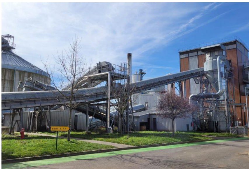
Chaufferie biomasse des Bellevues à Saint-Ouen-l'Aumône injectant la chaleur dans le réseau de Cergy-Pontoise Source : Communauté d'agglomération de Cergy-Pontoise
