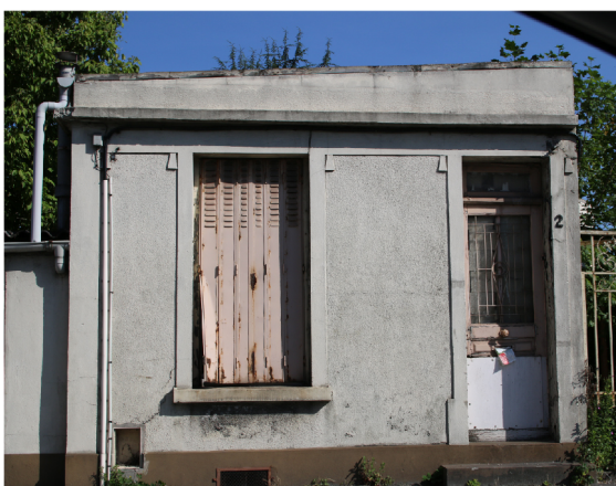
Habitat dégradé à La Courneuve
